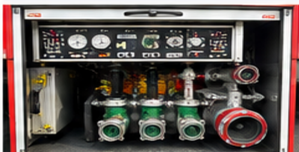
Bedienfeld Pumpe und Wasserführung
