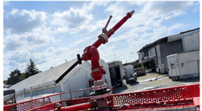
Wasserwerfer auf dem Dach
